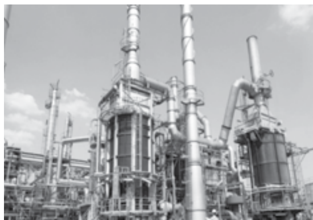
▲ ชื่องาน: PTTGC Wangnoi Compressor Station
