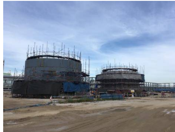
PTT LNG Tank Terminal
